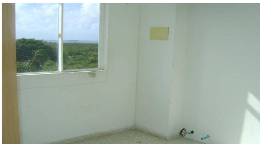
SALA DEL HOSPITAL DONDE SE UBICARAN LOS EQUIPOS DE RADIO
